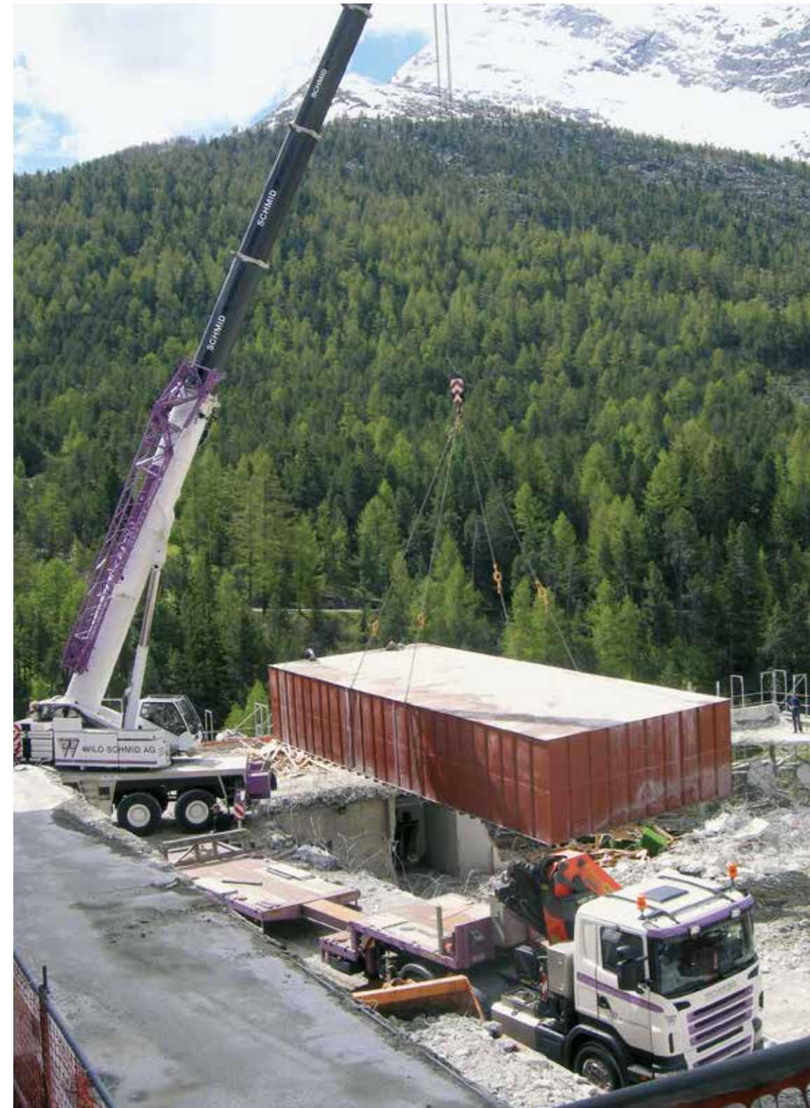
Einer der beiden 220'000 Liter Öl fassenden Stahltanks wurde in Präzisionsarbeit aus der Baugrube gehievt. Er musste dem neuen Aqua Allalin weichen, das mehr Platz als das alte Bad benötigte. Das Wellnesszentrum wurde vollständig neu konzipiert und gestaltet.
