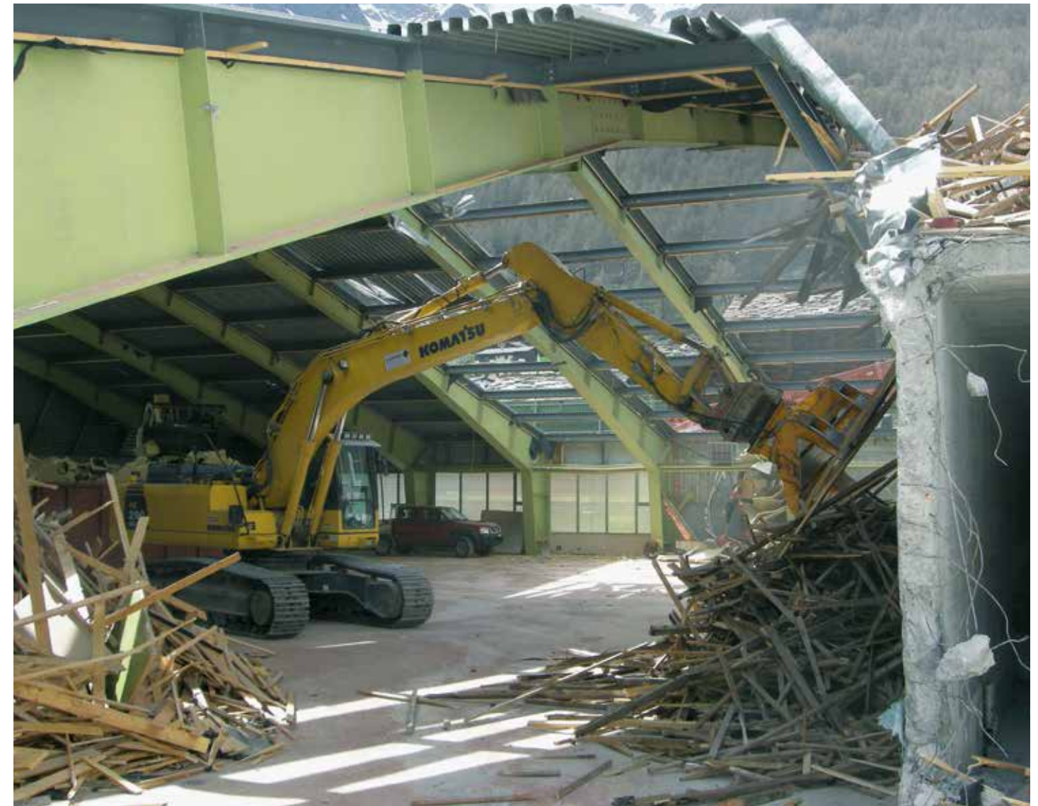
Die wuchtigen Stahlträger der alten Tennishalle mussten in aufwändiger und präziser Arbeit zerlegt und abtransportiert werden. Im Gegensatz zu den langen und teilweise sehr kontroversen Diskussionen um den Abbruch der Tennishalle war der heikle Rückbau rasch erledigt.
